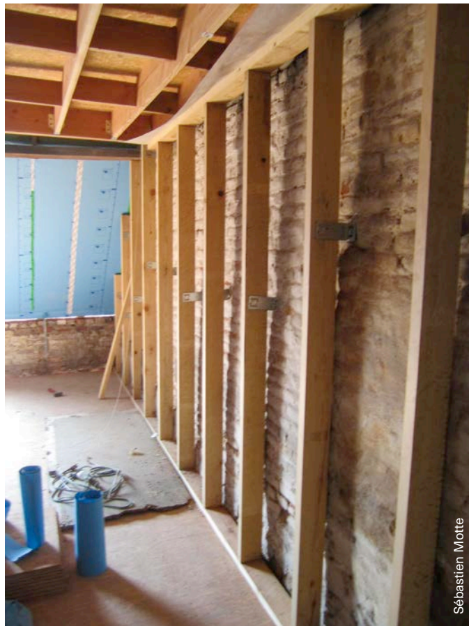
Fig. 4.1 Ossature fixée à un mur présentant d'importants défauts géométriques. Un système posé par collage nécessite une couche d'égalisation épaisse pour aplanir le mur.
