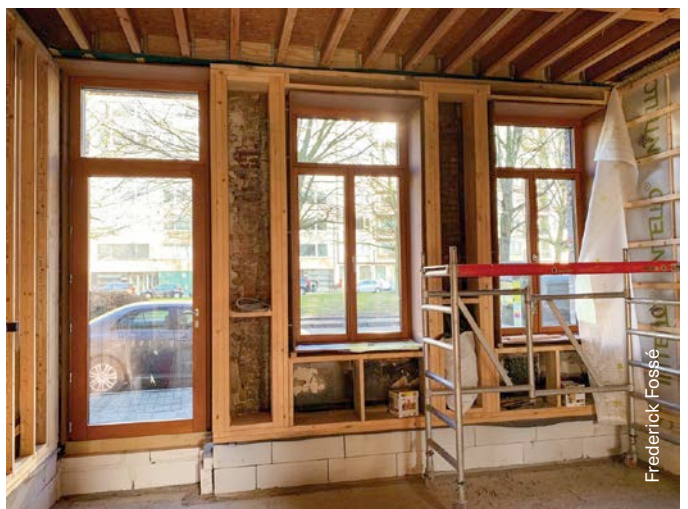
Fig. 6.26 Le plancher en bois au-dessus du rez-de-chaussée de la figure 6.25 a été remplacé par un nouveau plancher en bois qui ne se prolonge plus jusqu'à la façade, mais repose sur une ossature en bois.
