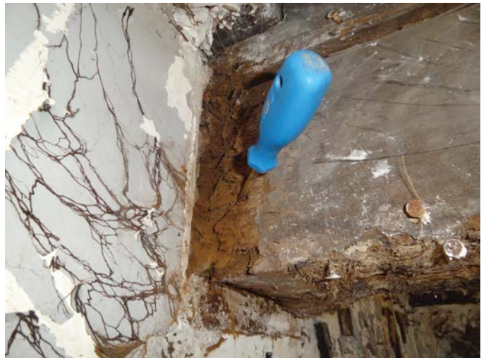
Fig. 2.10 Insertion d'un poinçon dans une solive en bois endommagée. Il est conseillé de déterminer la cause du dégât avant de réparer la solive ou de la remplacer.
