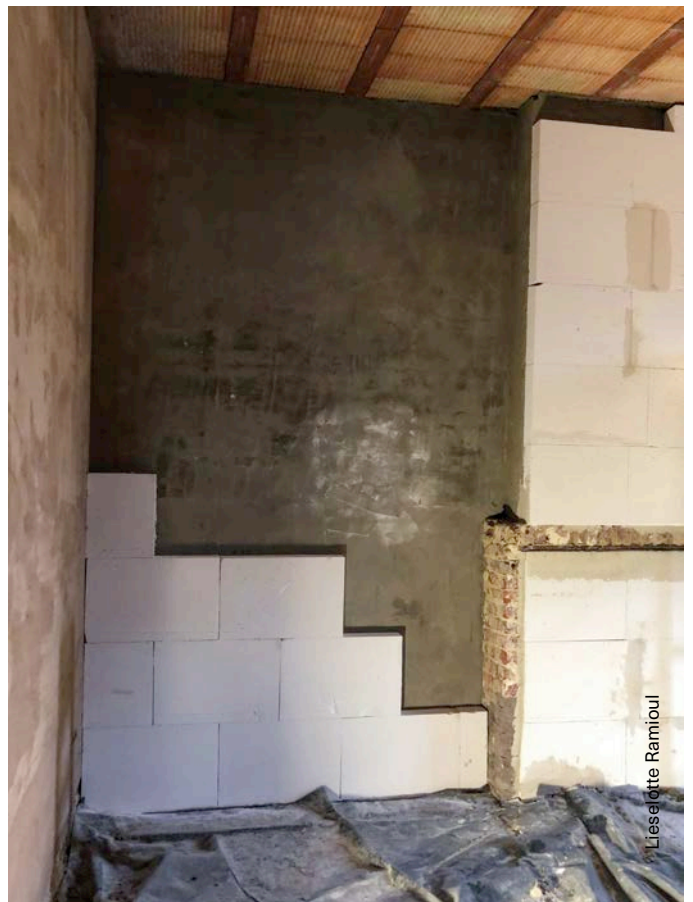
Fig. 3.12 Pose de panneaux isolants rigides sur un mur égalisé pour aplanir la surface.
