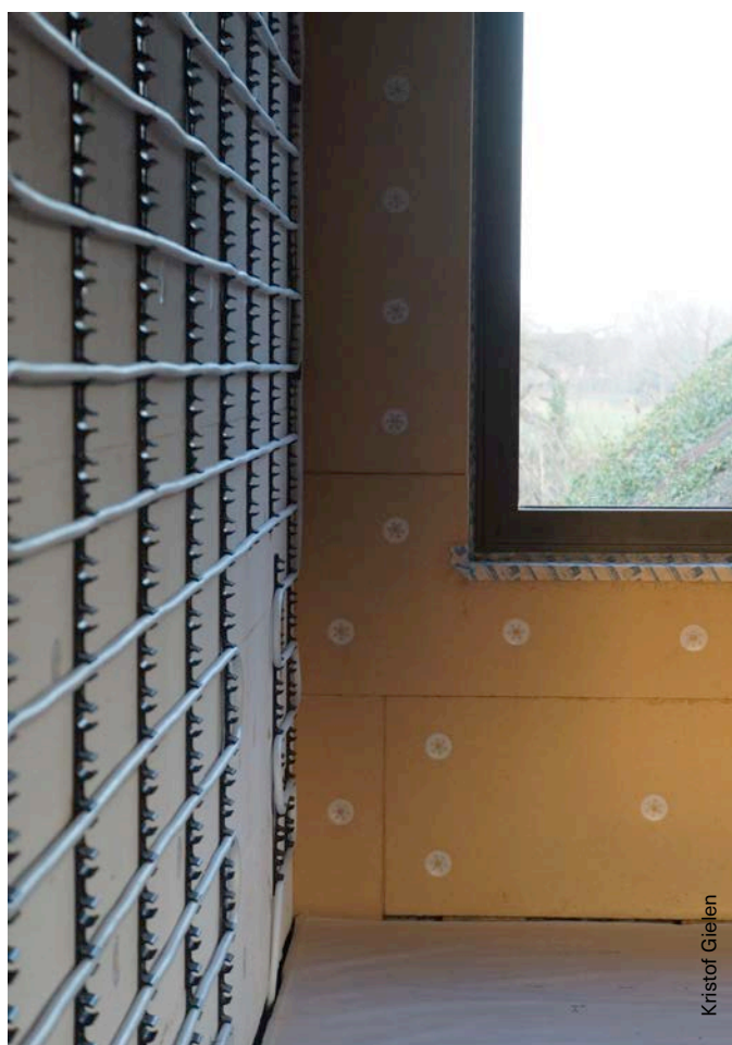
Fig. 6.33 Chauffage par le mur placé sur des blocs isolants à base de béton cellulaire ultraléger.
