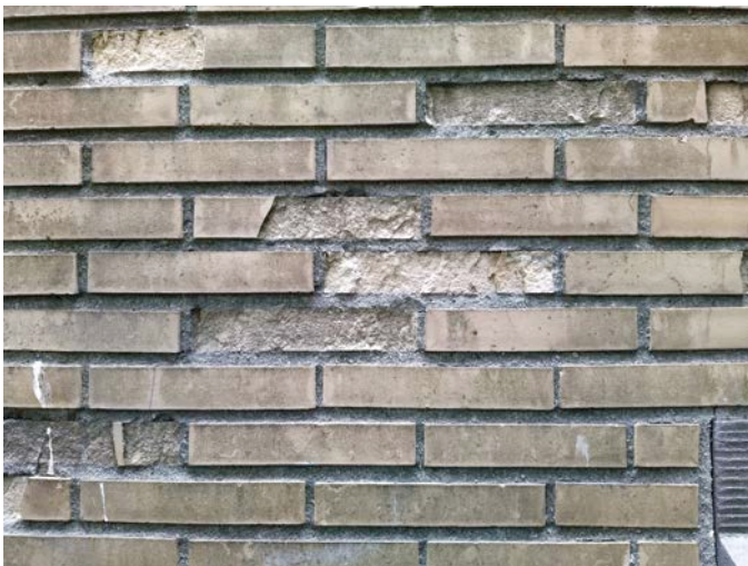
Fig. 2.5 Briques endommagées par le gel.
