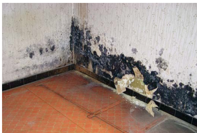
Fig. 2.1 Apparition de moisissures en raison des remontées capillaires. Il convient de traiter la cause du problème avant l'isolation par l'intérieur. Cette technique ne peut en aucun cas être utilisée pour camoufler des problèmes d'humidité existants.
