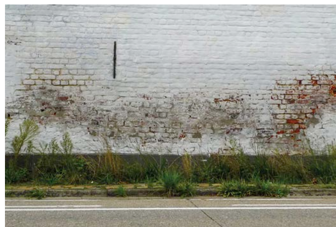
Fig. A.1 Façade endommagée par l'humidité ascensionnelle.
