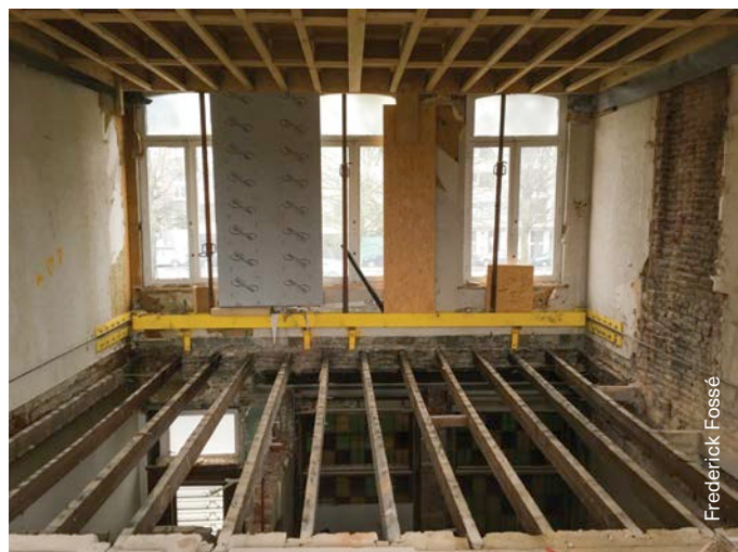
Fig. 6.25 Vue des solives d'origine au-dessus du rez-de-chaussée, qui se prolongent jusqu'à la façade avant. Elles seront bientôt remplacées par un nouveau plancher désolidarisé du mur extérieur, comme cela a déjà été fait à l'étage du dessus. Pour garantir la stabilité de la façade avant, cette dernière a été ancrée aux murs mitoyens au moyen d'une poutre métallique.
